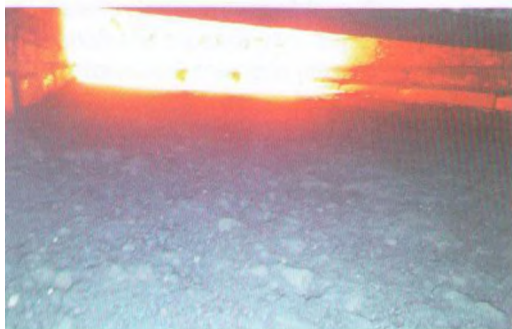
Рис. 6. Работа горелок ГНП.Р-250-31 горна агломашины
